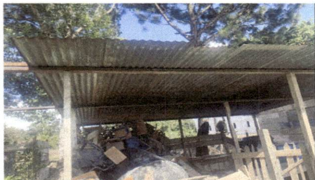
Foto 2: Estructura de techo de cocina en malas condiciones.
