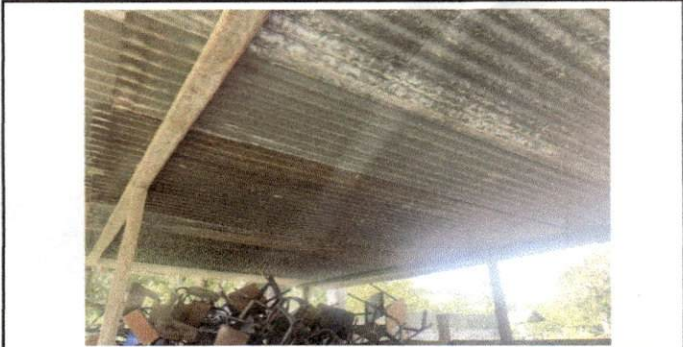
Foto 7: Lámina de la cocina corroída.
