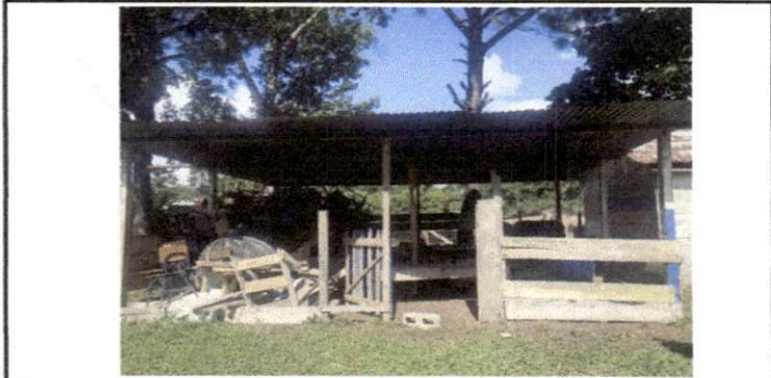
Foto 10: techo de cocina sin bajadas ni canal de agua.
