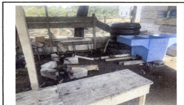
Foto 4: Cocina en malas condiciones.
